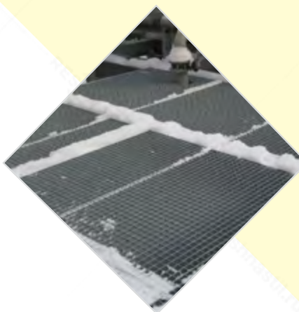
Рис. 2. Состояние ходового мостика из решетчатых настилов.
